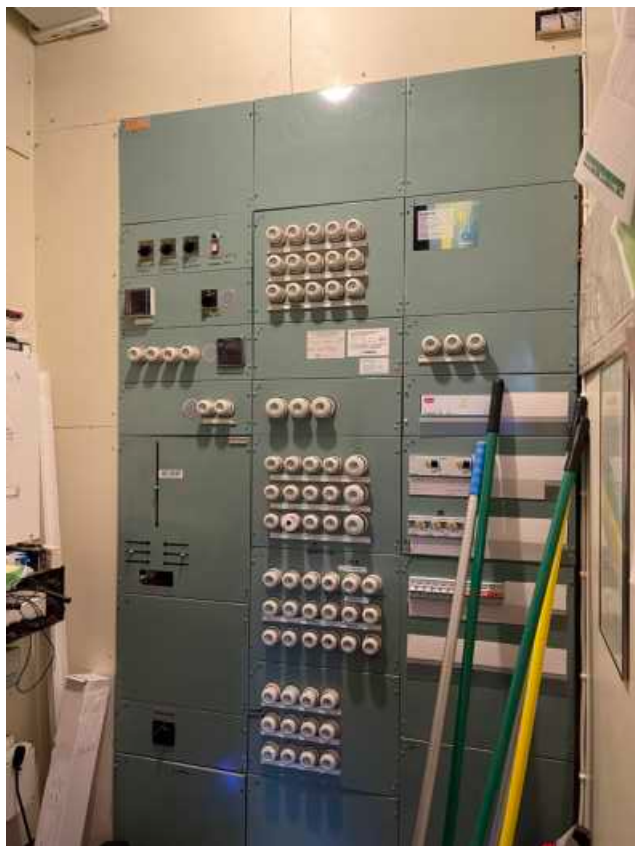
Sakastin tekninen tila, jossa sijaitsee sähköpääkeskus.
