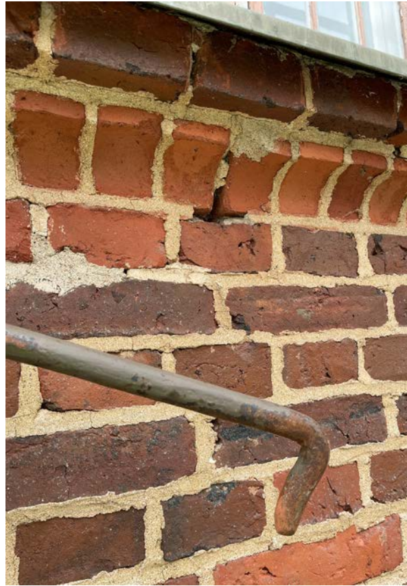
Eteläisen sivusakaran sisäänkäynnin ulko-oven salvan pidike puuttuu seinästä.
