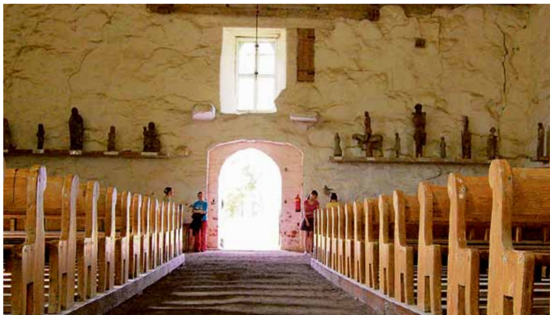
Halkeamien takia Sastamalan kirkon takaseinän hyllyltä on puuveistokset siirretty turvaan.
